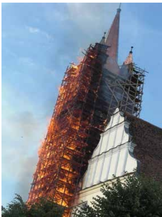
2. sz. kép. A beszercei templomtorony égő állványzata (forrás: beszercei tűzoltóság)
