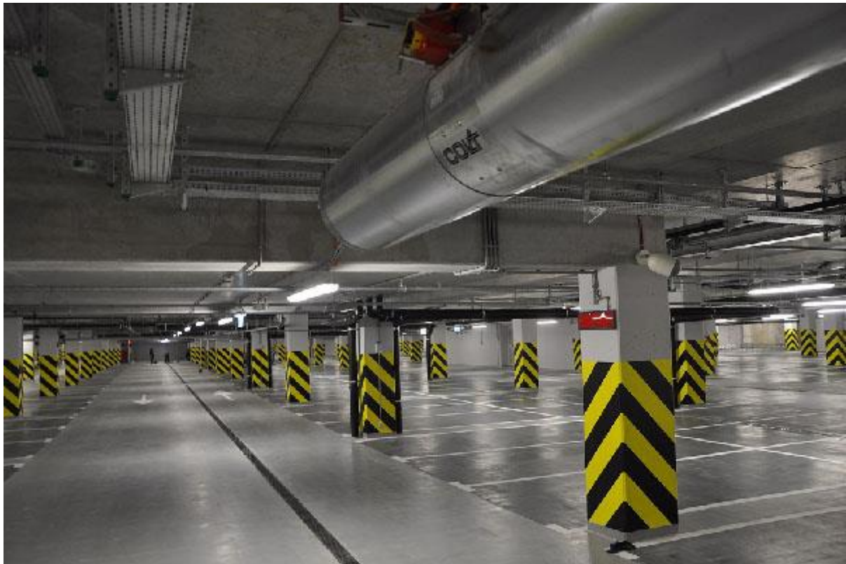
16 sz. kép. JET ventilátorokkal támogatott gépi hő- és füstelvezetés nagyméretű gépkocsitárolóban (forrás: COLT). A kép előterében látható JET ventilátorral szemben lévő lelógó gerenda akadályt képez, amelyet a JET ventilátor végein lévő lefelé döntött lamellák ellensúlyoznak
